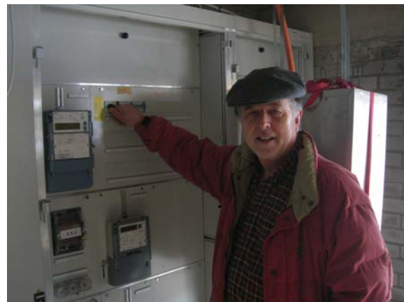
Walter Achermann schaltet die Anlage im Jonentäli am 18. Dezember 2013 ein
