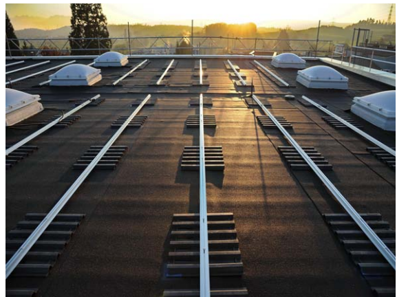
Die Tragschienen für die Solarpanels liegen auf dem Dach bereit (17.11.2011)
